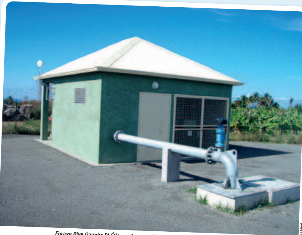
Forage Rive Gauche St-Étienne Amont – Périmètre irrigué du Bras de la Plaine
