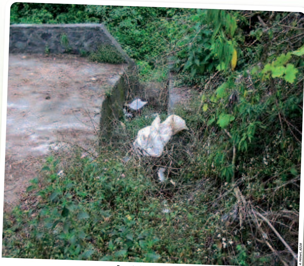
Exemple de fossé encombré
